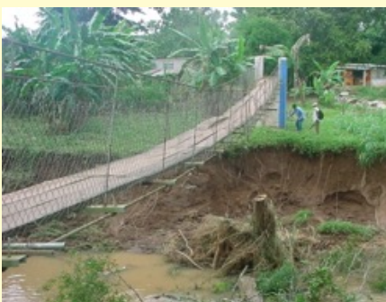
Erosión a orillas de ríos.
