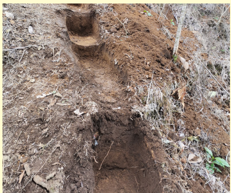
Caja de sedimentación
