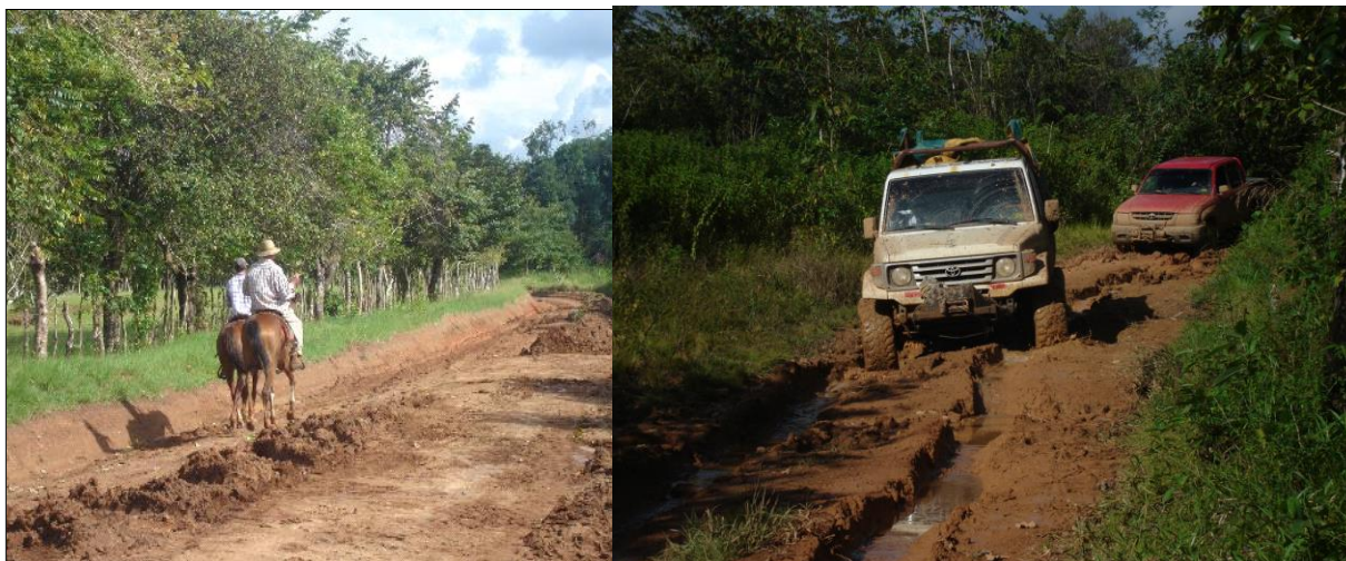
Fotografía 18. Estado de algunos caminos de tierra existentes en la cuenca media y baja del río Santa María
